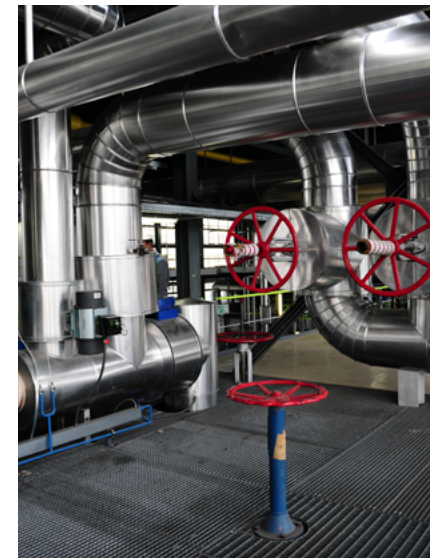
Chaudière du Lignon
