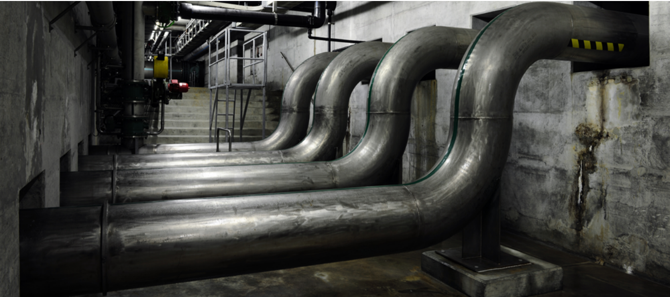
Conduites d'arrivée eau potable
