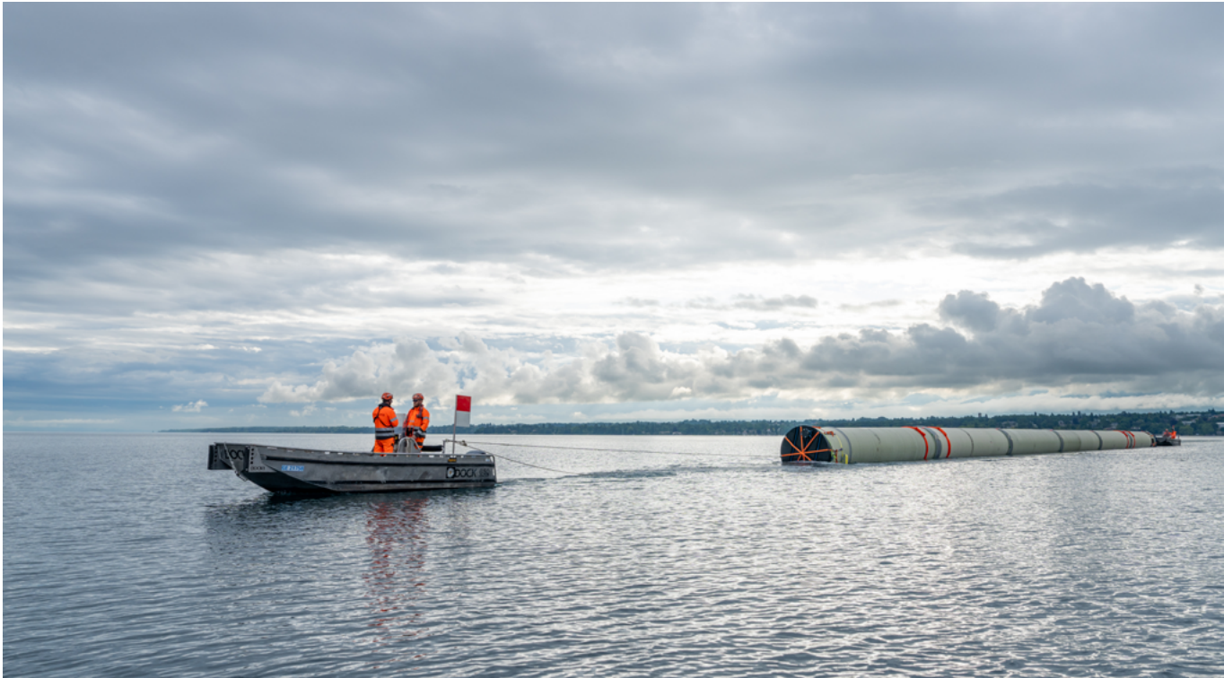
Conduites lacustres pour GeniLac
